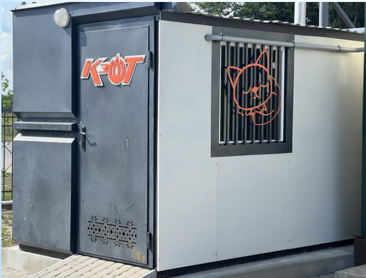
Встановлено твердопаливну котельню
